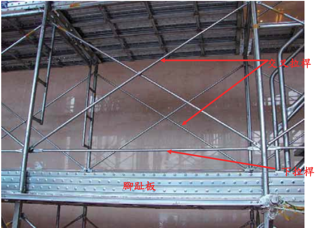
照片 1. 施工架（鷹架）當通道時兩側設置交叉拉桿，下方設置下拉桿。 （營造標準第 19、59 條、國家標準）
