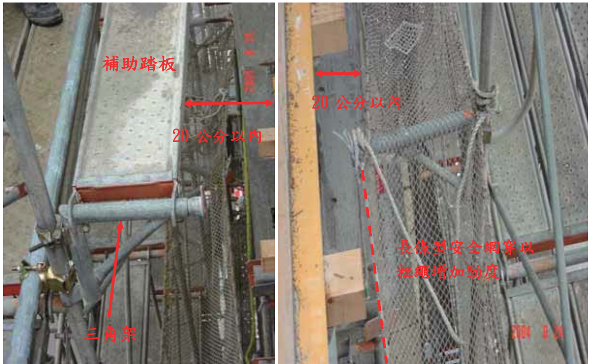
照片 2. 外牆作業時，施工架與結構體間使用三角架鋪設補助踏板或長條型安全網。 （營造標準第 19 條）
