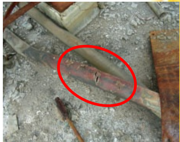
丙二醇甲醚儲槽基座附近 切割過的管線
