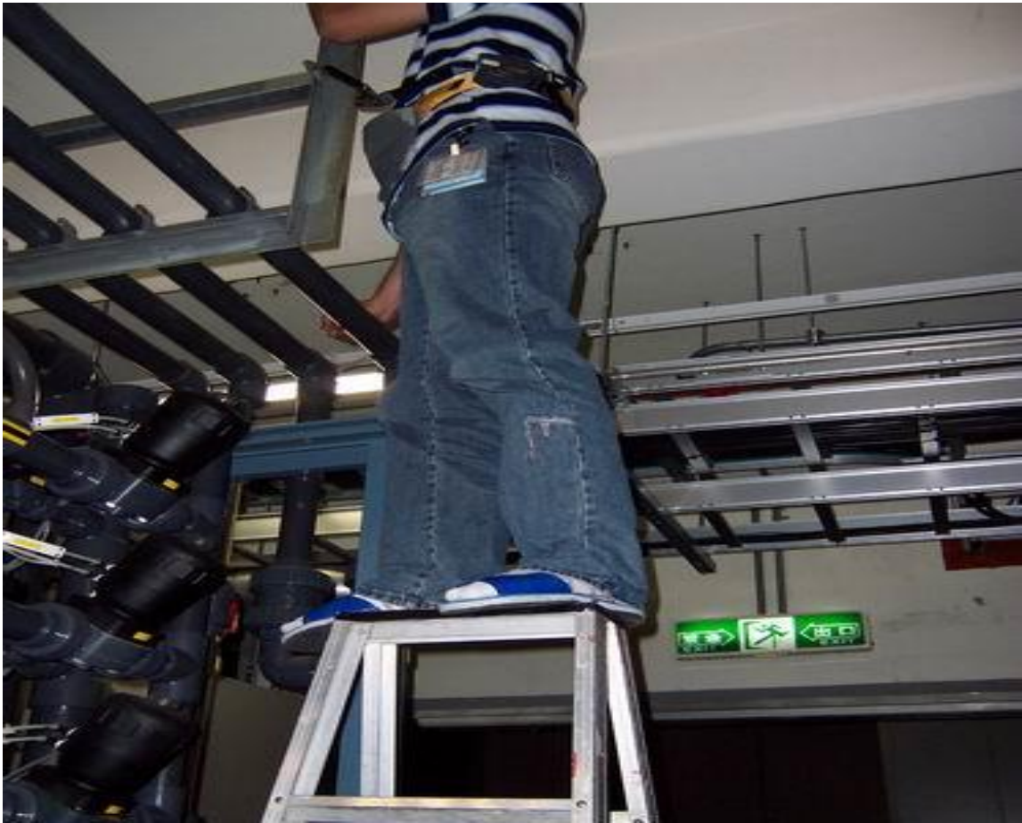
8、作業人員站立於合梯之頂板上作業，不符合規定之照片。
