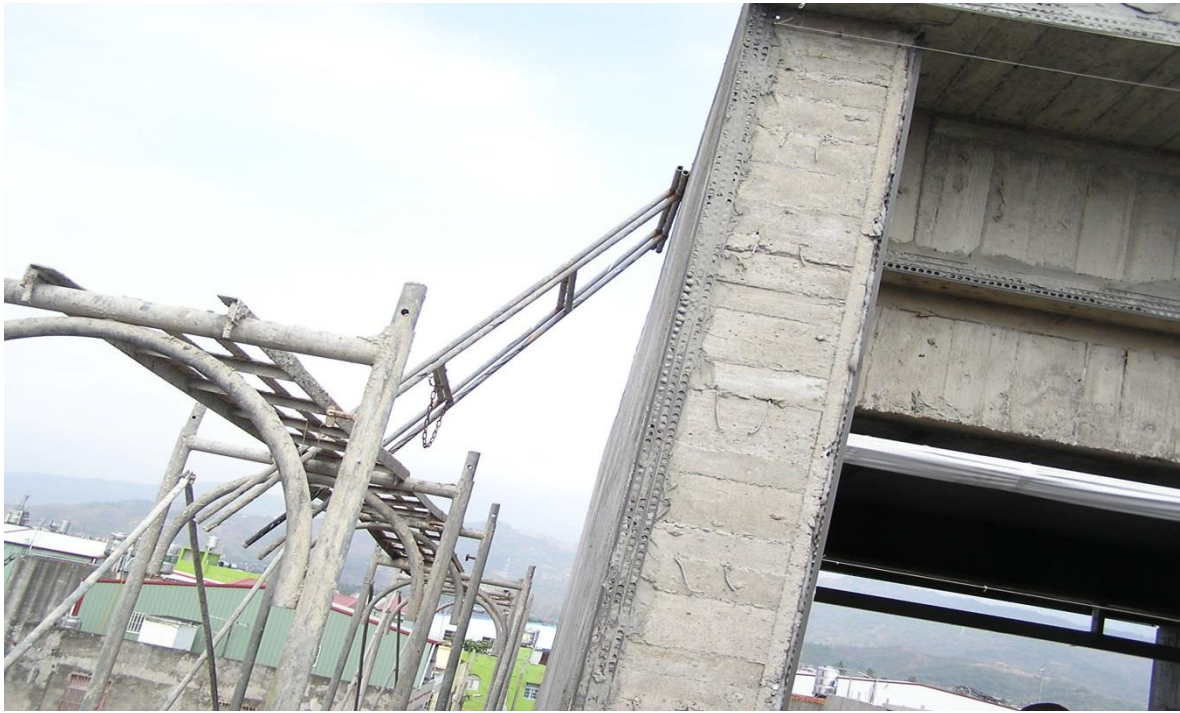
5、將移動梯、合梯置於施工架上使用，有墜落之虞不符合規定之照片。
