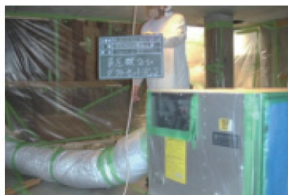
除塵裝備設置
