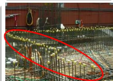
圖二、暴露於工作場所之鋼筋，應加裝護套等防護設施。
