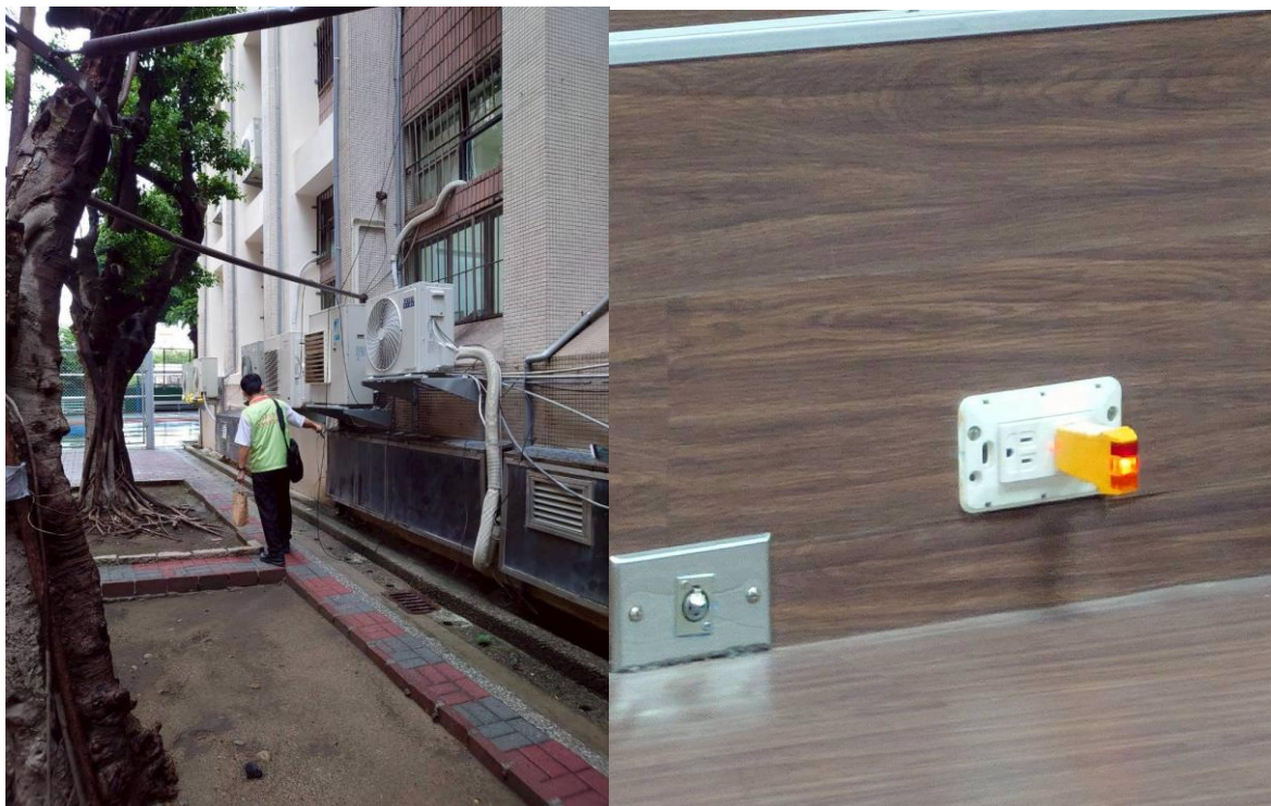
實地輔導(冷氣機漏電檢測及演講廳講台下方插座接地無效)
