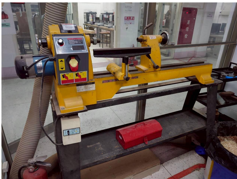
實地輔導(木工坊內加工設備安裝漏電斷路之開關已損壞)
