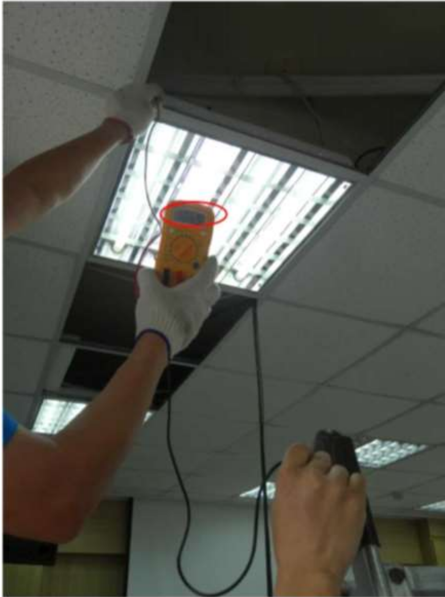
附照3 檢量測勾到地面插座電線裸露帶電體之鉛梯與天花板電壓差的106.9伏特
