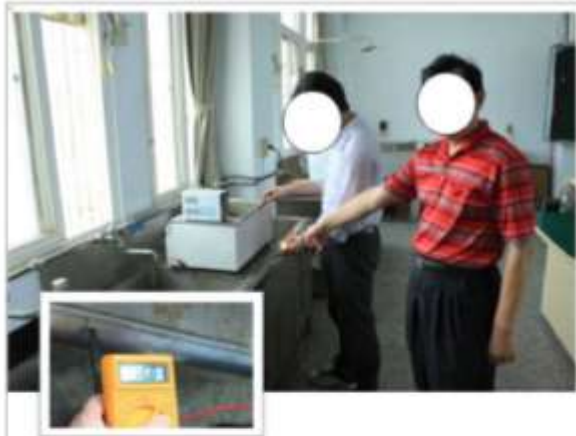
照片一 水浴槽放在不銹鋼水槽上抽電，以三用電表量測水浴槽及不銹鋼水槽間有 116.8V 電壓差
