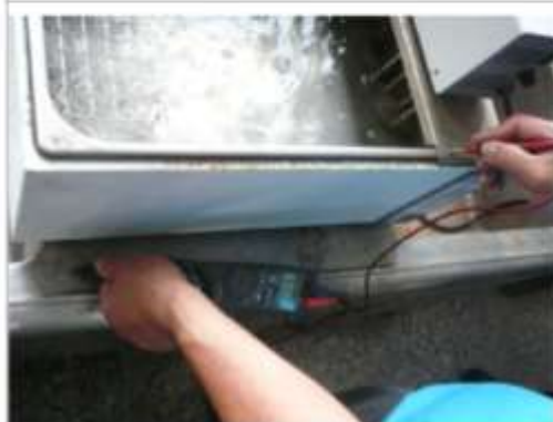
照片二 本所派員檢查當日，水浴槽放在不銹鋼水槽上抽電，用三用電表量測水浴槽及不銹鋼水槽間有 66.3V 電壓差
