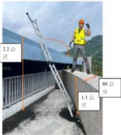
當時現場亦有搭移動梯，惟從屋頂下來拿工具時未使用移動梯，而是踩在女兒牆上方(註：女兒牆距頂樓高度約110公分，寬度約80公分)，並沿邊線行走。
