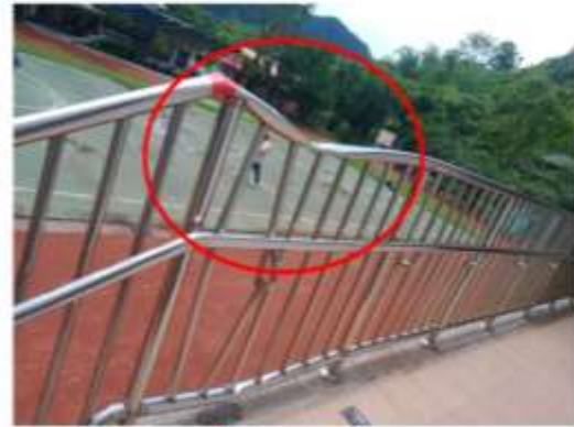
墜落時雙腳先撞到鐵欄圍住後，再掉落到地面。
