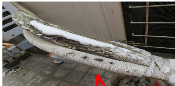
保溫層嚴重破損
